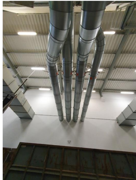
Pomieszczenie wentylatorów P.0.08 – kanały przy osi 19 i 20 (nie naniesione na projekcie technologii)
