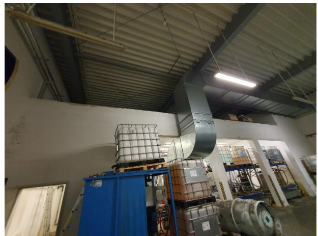
Pomieszczenie P.0.03 – stanowiska pompowni + strop żelbetowy
