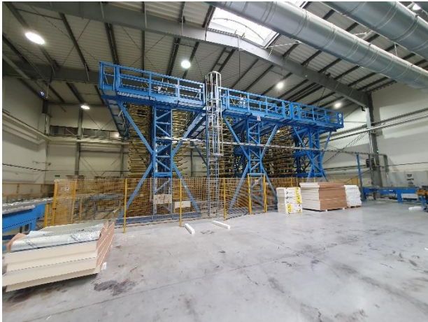
Nawa produkcyjna – linia do chłodzenia płyt
