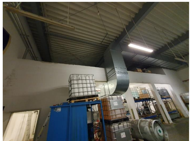
Pomieszczenie P.0.03 – stanowiska pompowni + strop żelbetowy
